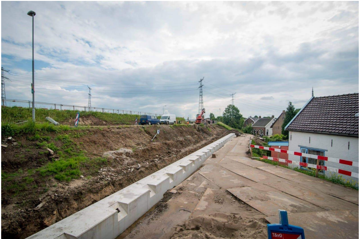
Constructie en grondaanvulling beïnvloeden huizen achter de Lekdijk in Nieuw Lekkerland
