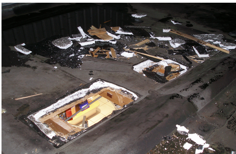
Gaten in het dak van Primera waar afgelopen woensdag werd ingebroken.
